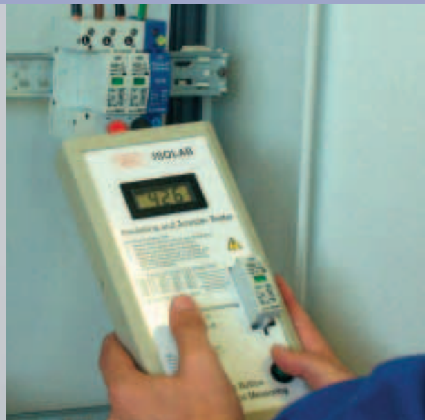
Измерение разрядников защиты от перенапряжения
