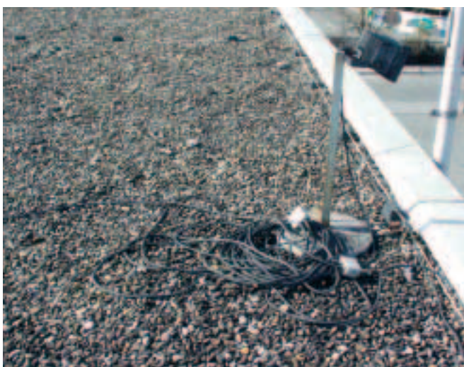
Неправильная инсталляция, наименьшее допустимое расстояние s не соблюдено, подсоединение разделительных искровых разрядников проведено неправильно, линия освещения должна быть проложена в области действия молниеотводной мачты.
